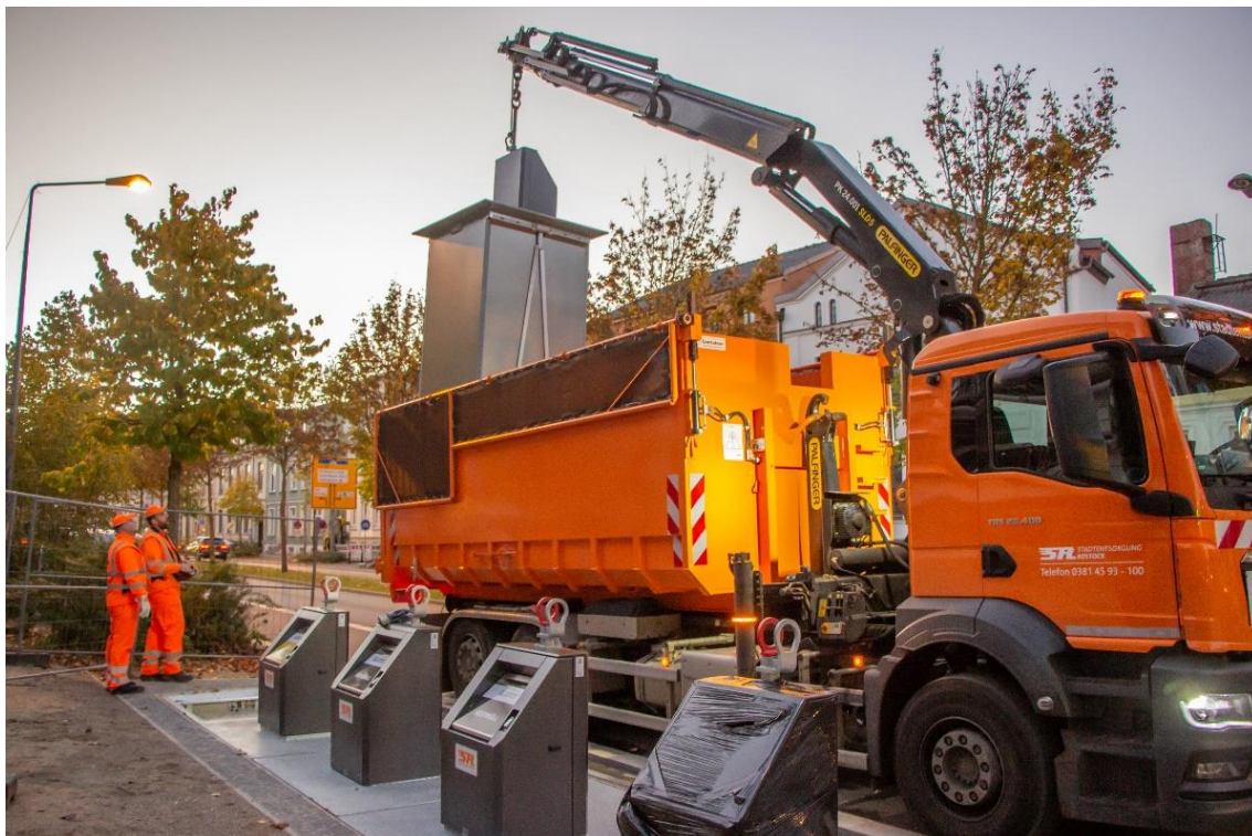
Entnahme des Unterflurbehälters aus dem Unterflursystem durch ein Entsorgungsfahrzeug mit ausgefahrenen Stützfüßen. (b)
