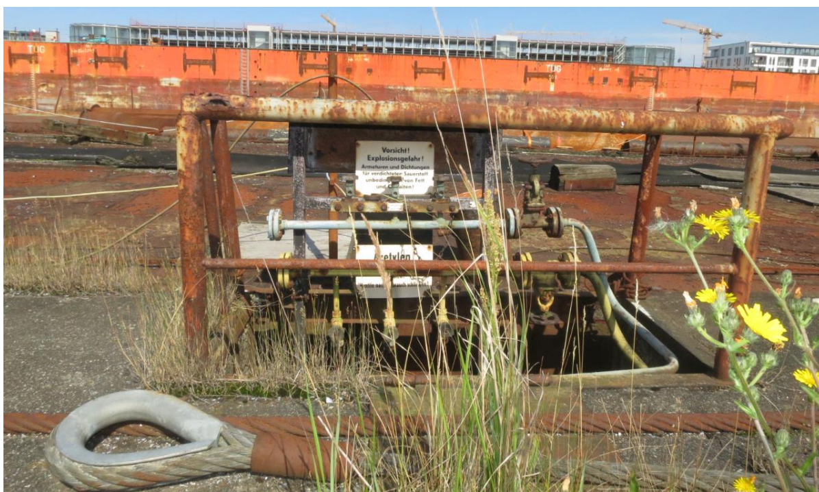
Abbildung 5: Rohrtrasse in der Kaianlage mit Altbestand Acetylenleitung
